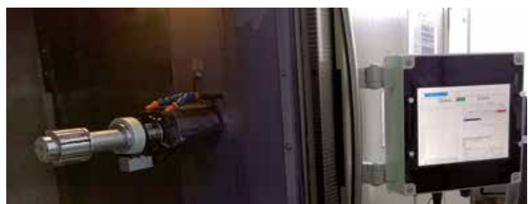
Beispiel Retrofit DMG DMU 60 H, Baujahr 2002
