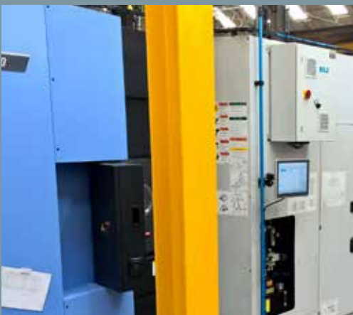
Beispiel Retrofit Doosan NHM 6300
